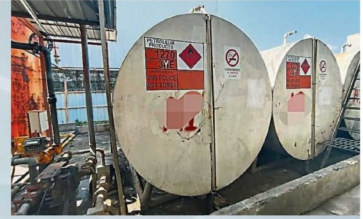
場內的滑槽式儲油槽，涉及非法貯存受管制的津貼柴油。(雪內貿局提供)
